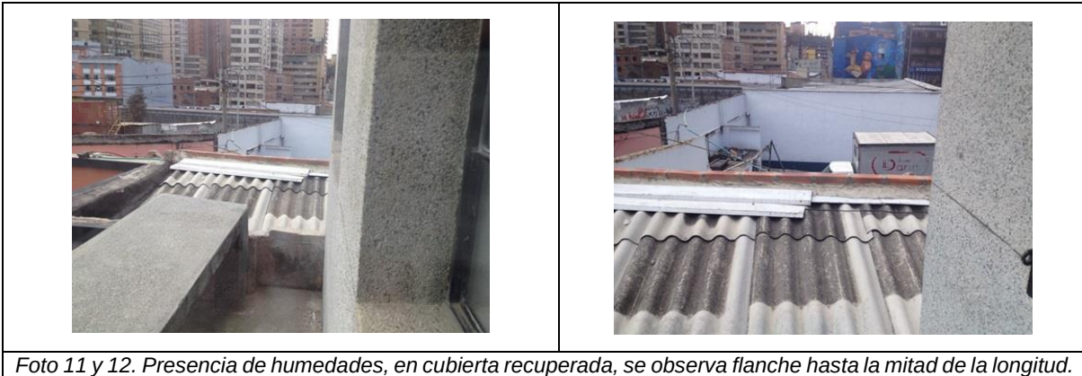
Foto 11 y 12. Presencia de humedades, en cubierta recuperada, se observa flanche hasta la mitad de la longitud.
